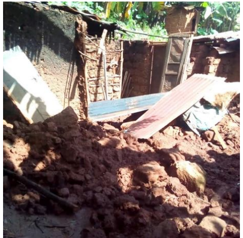
Dächer wurden in Ruanda durch Erdbeben zerstört. (Foto privat)
